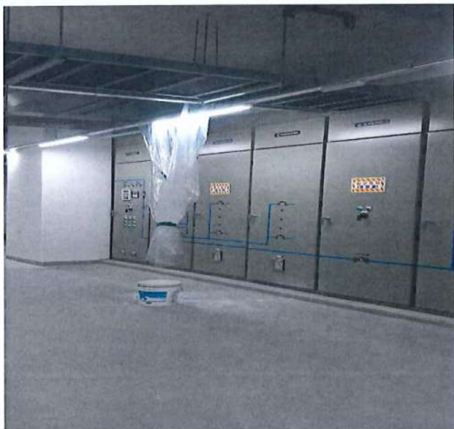
© M1동 지하 6층 전기실 특고압반 상부 누수 사진.
