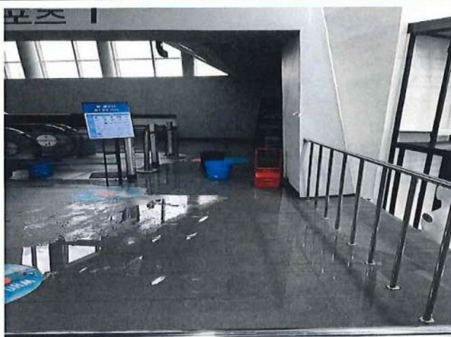
㉞ 에스컬레이터 주변 및 상부 누수 사진.
