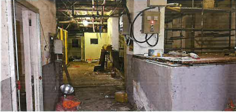
【 지하 3층 보일러실 전경 】
